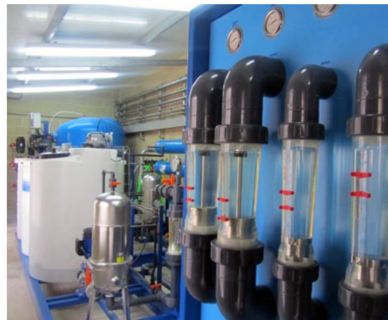
Imatge de la planta d'osmosi inversa de Can Sors.
