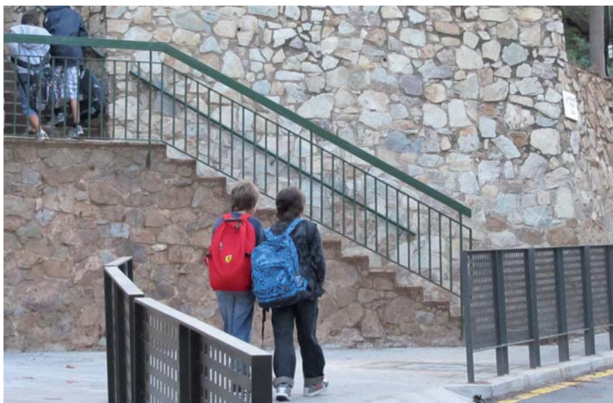
S'han instal·lat tanques metàl·liques de protecció en els revolts de l'avinguda de Ferran Fabra.
